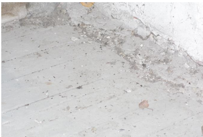
Fot. 2. Ślady guana pod kominem w południowo zachodnim rogu strychu.
