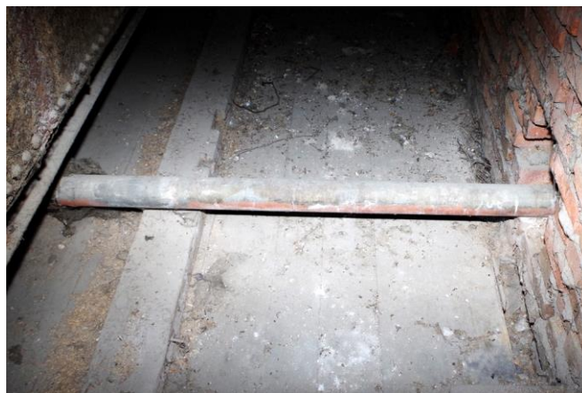
Fot. 3. Ślady guana pod ścianą na strychu środkowego skrzydła budynku.
