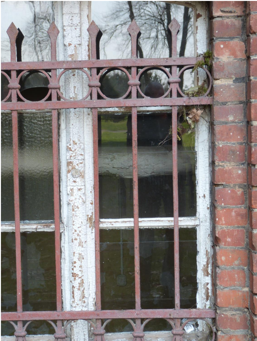
Fot. 9. Gniazdo kosa w budowie
