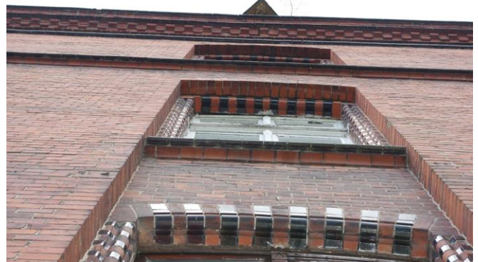
Fot. 7. Szczeliny przy oknach są w większości zbyt płytkie aby mogły się w nich chronić nietoperze.
