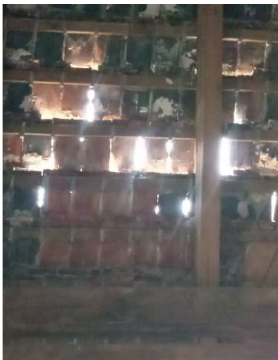
Fot.27. Zły stan pokrycia dachowego /znaczne prześwity/ - fragment połaci nad częścią frontową. Elementy drewnianej więźby narażone na zamakanie i porażenie grzybem – technicznym szkodnikiem drewna. Analogiczna sytuacja ma miejsce w różnych częściach przestrzeni strychowej całego obiektu. W miejscach przeciekania wody na podłodze pojawiają się zacieki, deski podłogowe ulegają destrukcji, która postępuje w głąb stropu i niszczy belki stropowe.
