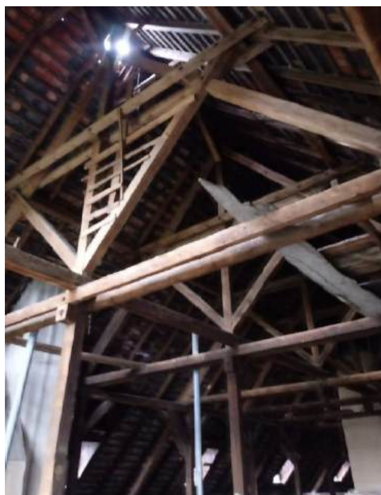
Fot.32. Fragment więźby dachowej – skrzydło b. Wiązary przy od strony ściany szczytowej remontowane/naprawiane. W kalenicy ubytki gąsiorów i dachówki – woda opadowa może swobodnie płynąć po elementach drewnianych.
