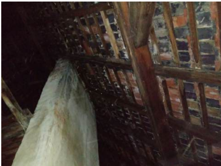
Fot.37. Elementy drewniane przy kominie z zaciekami, zawilgoczeniami, drewno ciemne, na elementach pomostu roboczego widoczne ślady porażenia przez grzyb.
