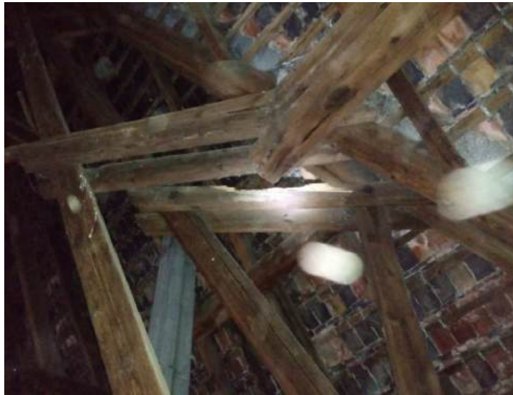
Fot.25. Zniszczone, spróchniałe kleszcz zastrzałów przy krokwiach koszowych, na drewnie ślady zacieków /część budynku jw./. Dół „dalszego” zastrzału zniszczony, wzmocniony obustronnymi przykładkami.
