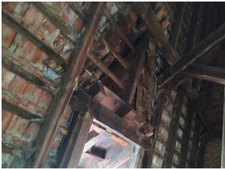
Fot.34. Konstrukcja lukarny, styk daszku lukarny z połacią /skrzydło b/. Elementy drewniane ze śladami silnych zacieków, szczególnie na deskach koszowych. Pozostałe lukarny w całym obiekcie znajdują się w podobnym - złym stanie technicznym.
