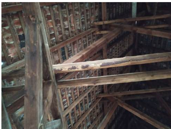
Fot.33. Elementy więźby /kleszcze/ wykonane z drewna z oflisami, zniszczone powierzchniowo przez ksylofagi. W kalenicy widoczne prześwity – ubytki lub uszkodzenia gąsiorów /część b obiektu/.
