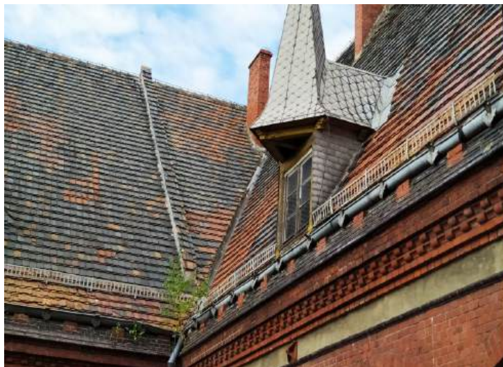
Fot.13. Naroże na styku połaci skrzydła środkowego -część a i części frontowej. Widoczny koci bieg. Stan techniczny pokrycia i obróbek zły.
