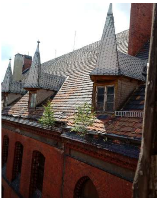
Fot.12. Widok na połączenie dachu nad skrzydłem środkowym - część b. Dachówki niejednorodne, pokruszone, rynny zdeformowane, zanieczyszczone, obróbki blacharskie skorodowane. W pasie przyokapowym ukorzeniła się roślinność /sporych rozmiarów drzewka/ powodując postępujące niszczenie elementów budynku.
