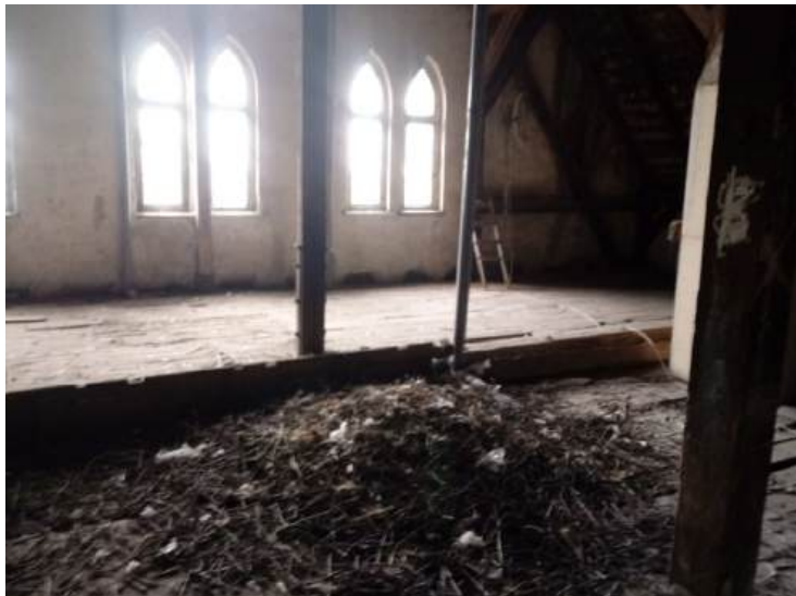
Fot.31. Skrzydło środkowe – część b, widok na ścianę szczytową. Podłoga z desek całkowicie zniszczona -stan awaryjny. Na pierwszym planie pozostałości zniszczonego gniazda.
