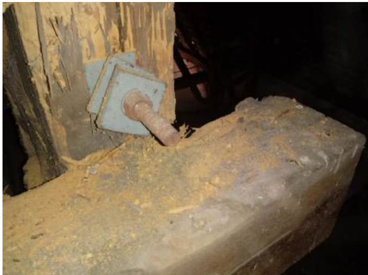
Fot.23. Fragment słupa /środkowy odcinek/ w części frontowej - połączenie z częścią a. Drewno porażone przez owady -techniczne szkodniki drewna /zidentyfikowano żerowanie spuszczela/. Widoczne kanały larwalne z mączką drzewną. Zniszczenie elementu powierzchniowe.
