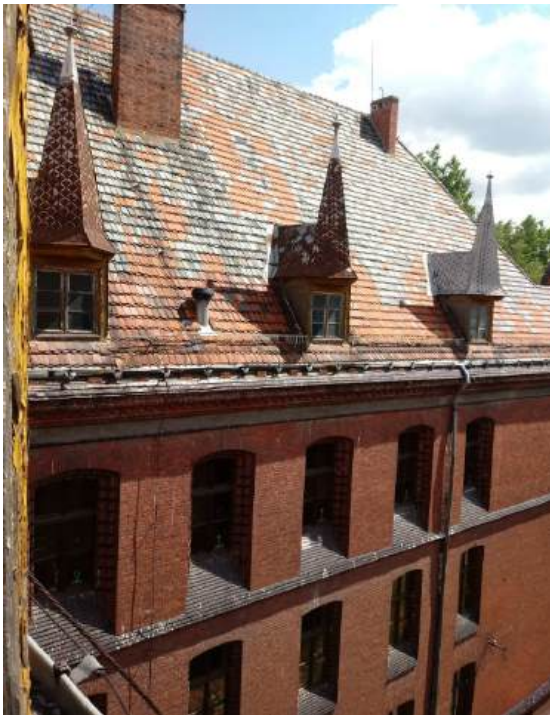
Fot.8. Połączenie dachu skrzydła a -strona Pd-Zach. Dachówka różnorodna/przekładana, rynny wykrzywione, płotki przeciwniegięte skorodowane, zdeformowane. Na elewacji widoczne zanieczyszczenia -odchody ptasie.
