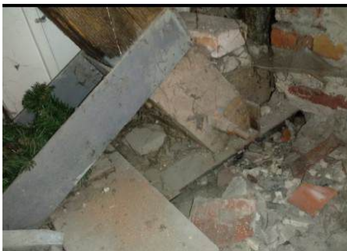
Fot. 66. Przebudowany strop i wiązary w skrzydle frontowym. W wiązarze głównym widoczne przykładki stalowe i ściąg między zastrzałem a ściągami
