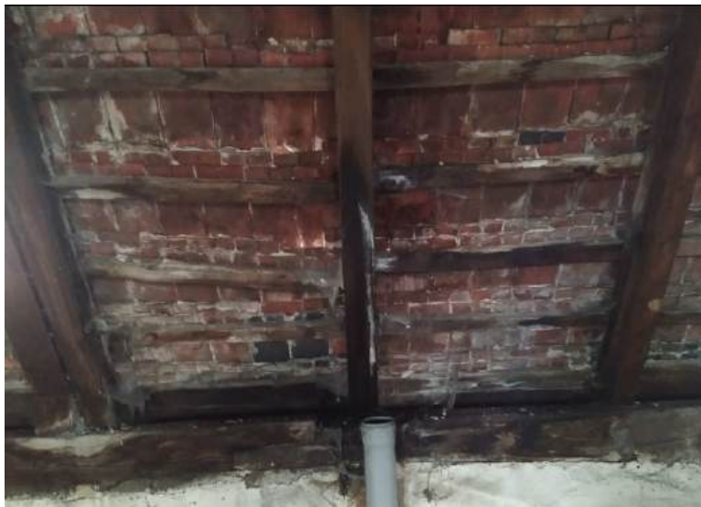
Fot.52. Miejsce wyprowadzenia odpowietrzenia kanalizacji. Elementy drewniane zawilgocone, drewno miejscowo miękkie,łaty zdeformowane/ugięte. Na krokwi widoczny grzyb – techniczny szkodnik drewna, w stanie aktywnym.
