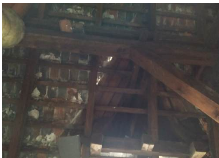
Fot. 53. Widok na elementy lukarny /część c/. Pokrycie dachowe nieszczelne, obróbka zdeformowana, na drewnie liczne zacieki i zawilgocenia.
