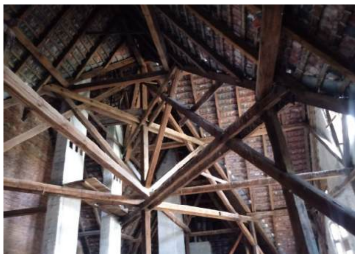
Fot.17. Fragment więźby w centralnym miejscu części frontowej -połączenie ze skrzydłem środkowym b. Belki drewniane silnie zanieczyszczone odchodami ptasimi /środowisko agresywne/.
