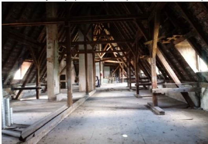
Fot.60. Widok poddasza w części frontowej. Ściąg wiazara wieszarowego wzmocniono ceownikami C260. Belki pośrednie drewnianian wymieniono na stalowe INP240. Poszycie ze sklejki na blasze fałdowej
