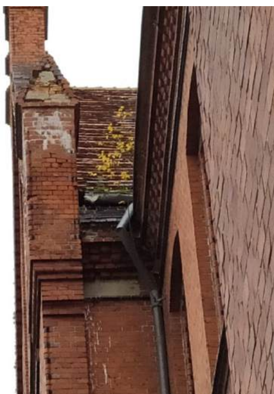
Fot.15. Widok z boku na fragment ściany frontowej i dachu nad częścią środkową. Ubytki dachówki, cegły i zaprawy, zdeformowane rynna, roślinność w strefie przyokapowej.
