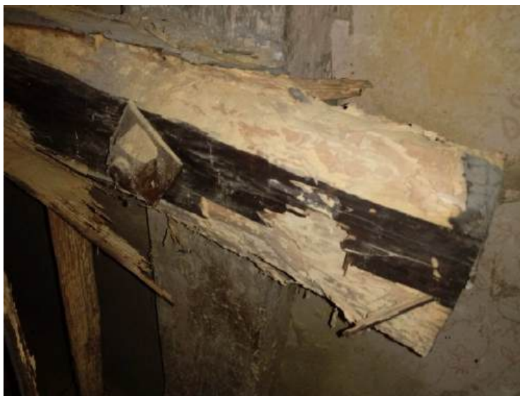
Fot.41. Kleszcz wiązara głównego więźby /część a/. Drewno miękkie, kruche, rozpada się przy dotknięciu – zniszczone przez grzyb i owady spuszczała -stan awaryjny.
