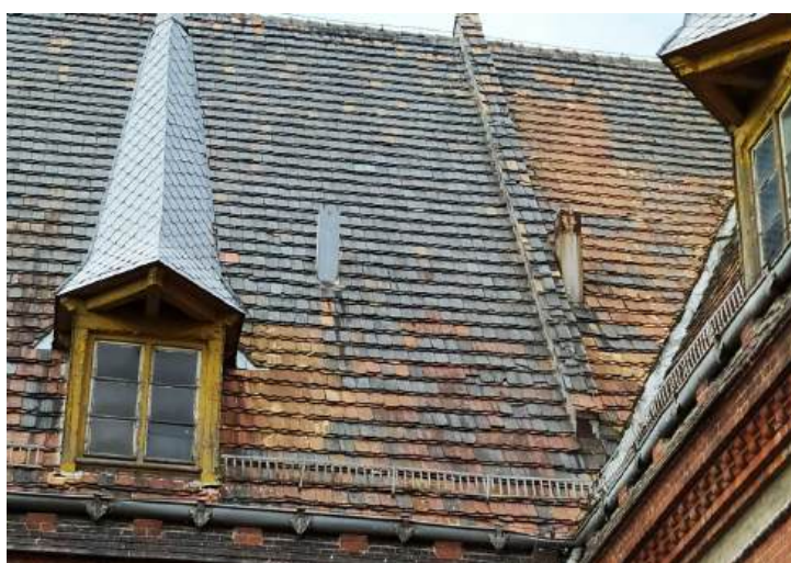
Fot.14. Naroże na styku połaci skrzydła bocznego -część c i części frontowej. Widoczny koci bieg. Stan techniczny pokrycia i obróbek zły.
