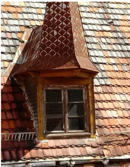
Fot.9. Widok lukarny w połączeniu dachu jw. Stalarka okienna całkowicie zniszczona, pokrycie daszku lukarny skorodowane. Dachówki na połączeniu w złym stanie technicznym.
