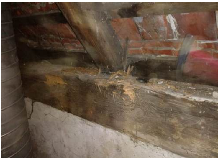
Fot.38. Fragment murłaty i krokwi /skrzydło a/, drewno powierzchniowo skorodowane, miękkie ze śladami zacieków.
