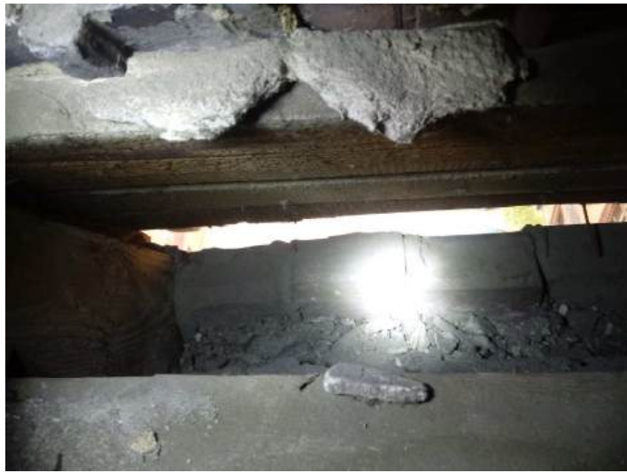
Fot.28. Strefa przyokapowa, widoczne ubytki cegły w gzymsie -prześwity /analogicznie w różnych częściach budynku. W obrębie całego obiektu przestrzeń za murlatą jest zanieczyszczona /zaśmiecena/ materiałami różnego pochodzenia.
