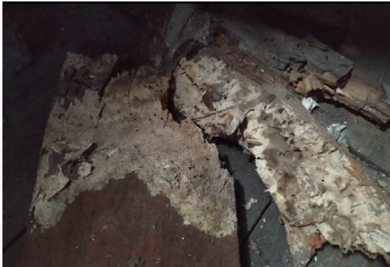
Fot.55. Deski podłogowe, od strony wewnętrznej /od stropu/ porażone przez grzyb, widoczna grzybnia i sznury – stan aktywny. Drewno zniszczone, spróchniałe.
