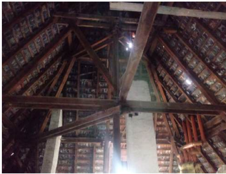
Fot.46. Więźba dachowa; widok w kierunku ściany szczytowej - część c. Pokrycie dachowe z licznymi prześwitami/ubytkami, na drewnie widoczne zacieki.
