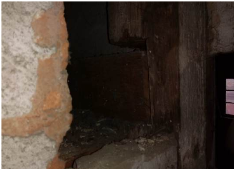
Fot.43. Przykład błędu sztuce budowlanej – dla zamontowania rusztu pod sufit podwieszony podcięto do 1/3 przekroju słup wiązara głównego więźby dachowej – stan awaryjny.
