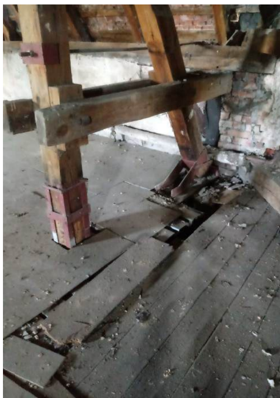
Fot.18. Wzmocnienie podstawy słupa i zastrzału wykonane w trakcie wcześniejszego remontu. Stężenie wiązara /słup – murłata/ wykonano dla wszystkich wiązarów w części frontowej. Widoczny styk stropu remontowanego/wzmacnianego i fragmentu stropu starego nieremontowanego.
