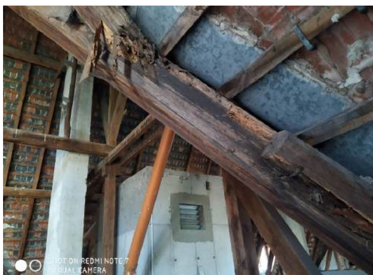
Fot.20. Krokiew koszowa /w miejscu jw./ zniszczona, spróchniała na całej długości do 1.go węzła, wzmacniana przykładkami, do wymiany.
