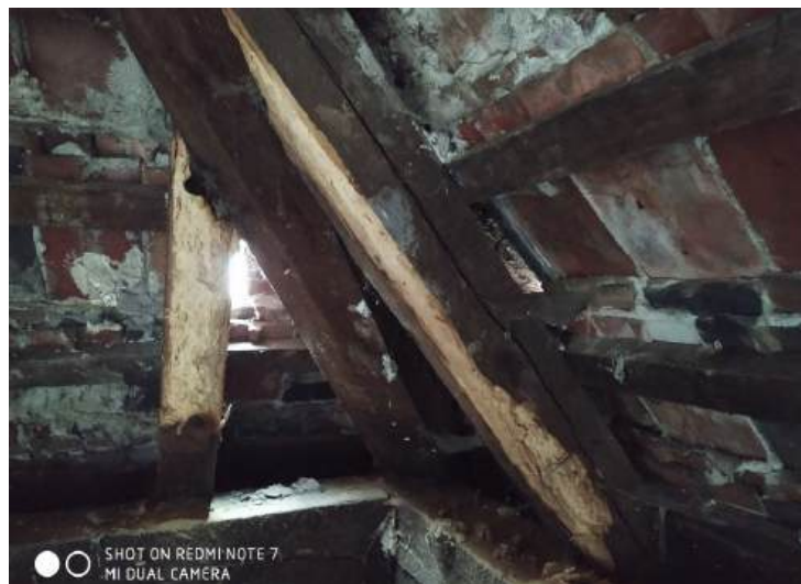
Fot. 26. Naroże /część budynku jw./ z całkowicie skorodowanymi krótkimi krokwiemi i zniszczoną końcówką krokwi koszowej, z powodu zamakania drewna – nieszczelne pokrycie i obróbka.
