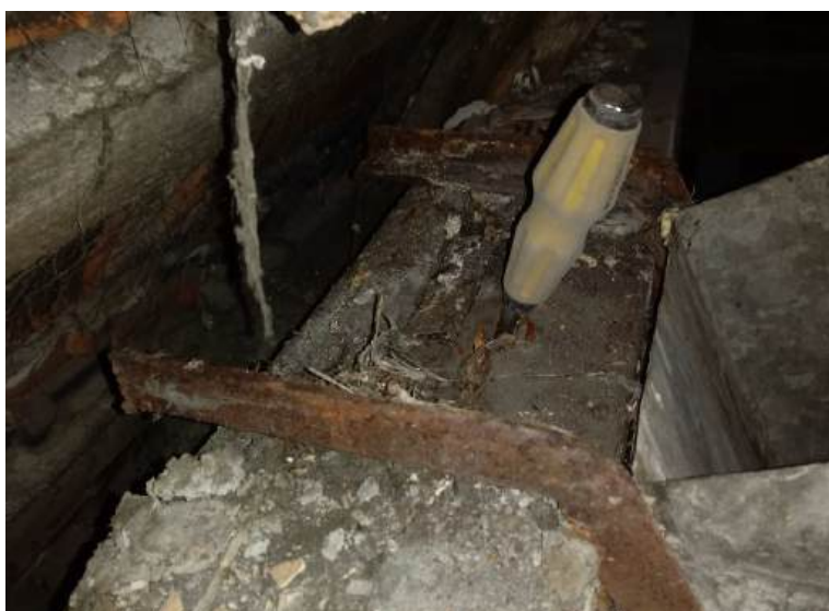
Fot.50, 51. Zniszczona płatew przy wylotach kanałów wentylacyjnych; na znacznej długości w kilku miejscach. Drewno miękkie, kruszy się, ostre przedmioty wchodzi w głąb „jak w masło”, nastąpiła całkowita destrukcja materiału.
