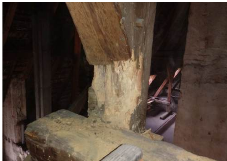
Fot.24. Fragment słupa po przeciwnej stronie budynku, w części frontowej- połączenie z częścią c. Widoczne ślady żerowania spuszczela - kanały larwalne z mączką drzewną. Zniszczenie elementu powierzchniowe.
