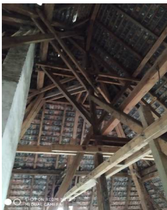
Fot.21. Widok więźby w części frontowej - połączenie z częścią a. Więźba była remontowana/przebudowywana, wiele elementów jest wtórnych o zmienionych przekrojach, część jest dodanych, nowych /słup, kleszcze/.
