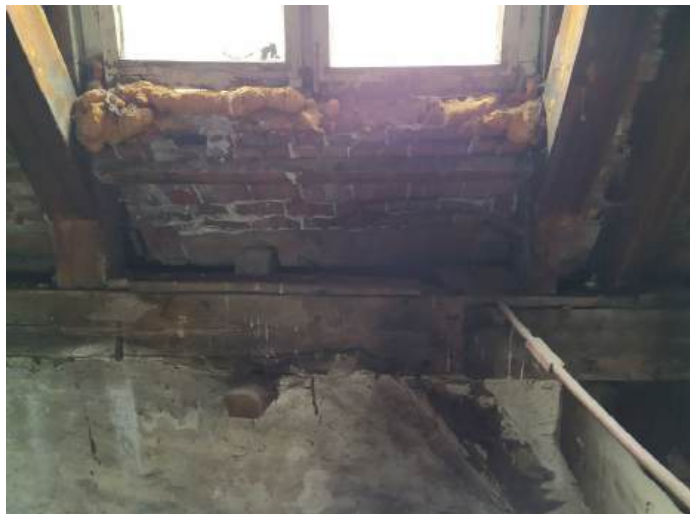
Fot.29. Widok na fragment okna lukarny i elementy konstrukcji lukarny /część frontowa/. Prowizoryczne uszczelnienie , brak parapetu, zacieki na murze, murłacie i elementach drewnianych więźby. Widoczne wtórne stężenie wiażara /słupek – murlata/.
