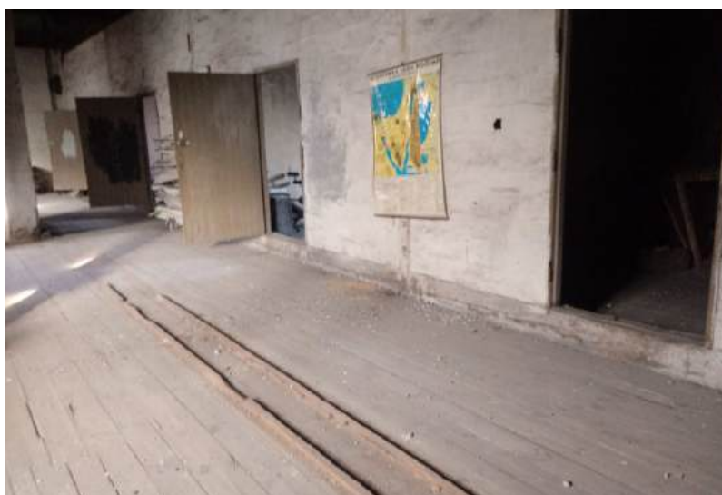
Fot.44. Ugięta i pęknięta podłużnie podwalina, ugięta podłoga, deski zniszczone. Słup /w ścianie/ wzmocniony obustronnie przykładkami, spróchniały, miejscowo ociosany.
