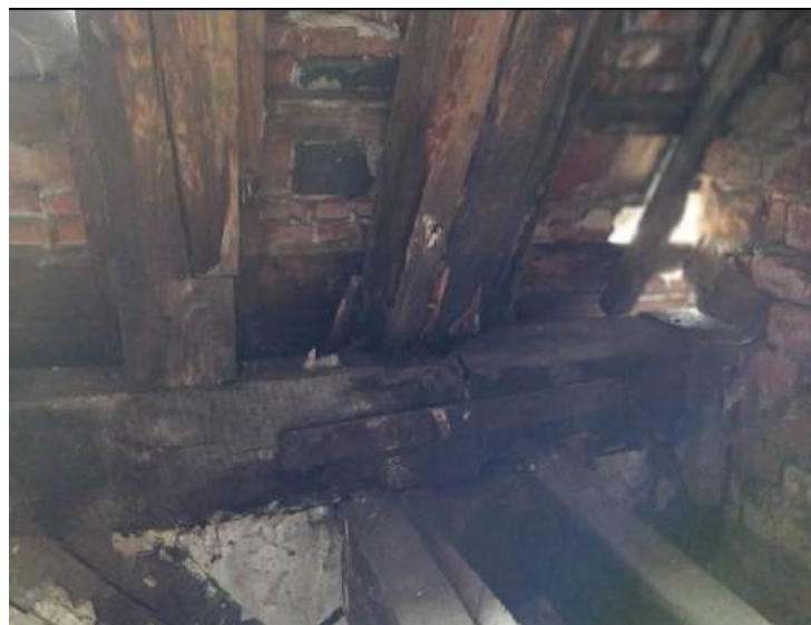
Fot.48. Widok naroża w miejscu jw. Zniszczone, spróchniałe elementy drewniane – murłata, krokwie (wcześniej wzmacniane przykładkami), deski podokapowe. Nieszczelne pokrycie dachowe; ubytki dachówki, zniszczone obróbki.
