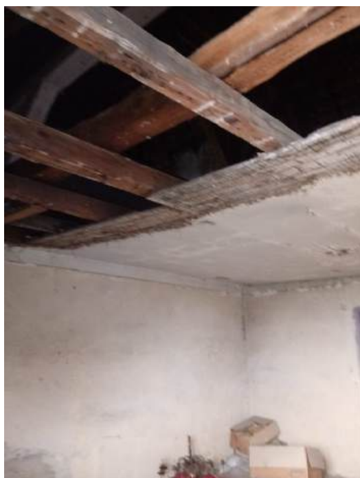
Fot.39. Jedno z pomieszczeń poddasza /skrzydło a/. Na drewnianym ruszcie podwieszony strop -maty z trzciny z tynkiem wapiennym, w chwili obecnej w stanie awaryjnym.
