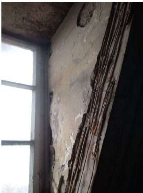
Fot.40. Lukarna w jednym z pomieszczeń – ścianka obłożona supremą i otynkowana, stolarka z resztkami farby.
