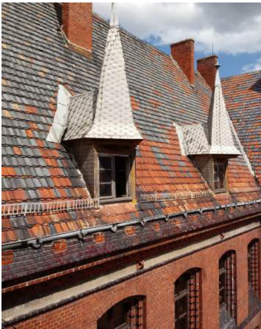
Fot.10. Fragment połączenia dachu nad częścią c na styku z częścią frontową. Dachówka niejednorodna, przekładana. Obróbki blacharskie przy kominach porzewiały.
