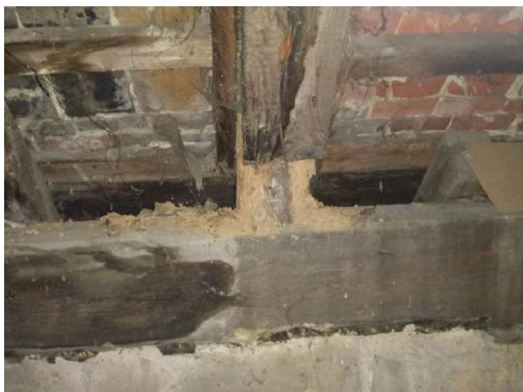
Fot. 42. Elementy drewniane – murłata, słupek lukarny, krokiew i łąty zawilgocone; miejscowo całkowicie skorodowane, spróchniałe miękkie.
