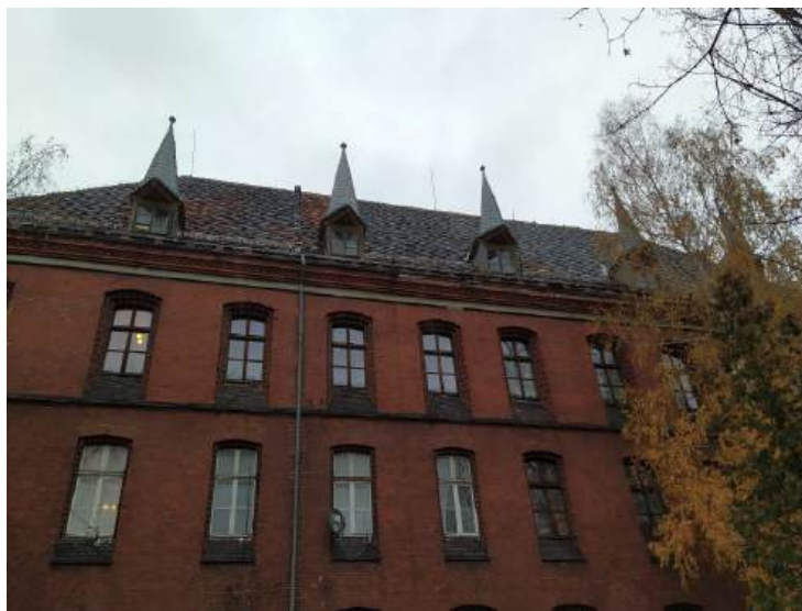
Fot.6. Skrzydło boczne -część c. Gzyms na prawie całej długości był odtwarzany/remontowany.
