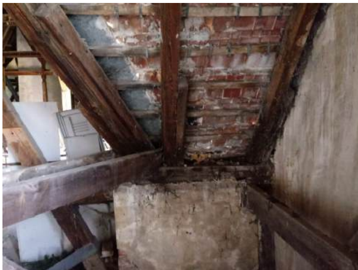
Fot.19. Część frontowa- część centralna przy ścianie frontowej. Widoczne zacieki na ścianach /tynk odparzony/ i elementach drewnianych. Murłata i krokwie, w szczególności koszowa, przegniłe, wzmacniane. Pokrycie i obróbki nieszczelne.
