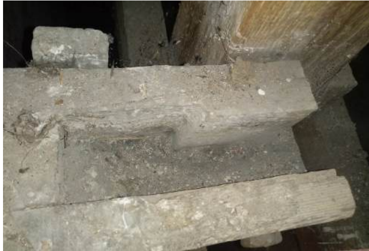
Fot.22. Końcówka /miejsce łączenia/ podłużnej belki stężącej więzary główne w części frontowej. Kolejny fragment belki usunięto -brak stężenia.
