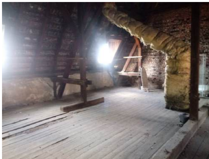
Fot.47. Fragment poddasza – skrzydło boczne c na styku z częścią frontową, widoczna ściana oddzielająca obie części. Zniszczone, na skutek zamakania, deski podłogowe /pod nimi belki stropowe/, ugięta podłoga.
